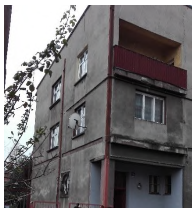
Rysunek 38 Zarębskiego 7a – przed modernizacją
