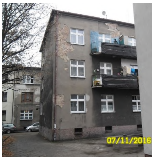
Rysunek 46 Szelgiewicza 3c – przed modernizacją
