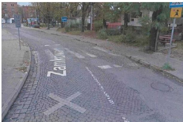
Ul. Zamkowa – przed remontem
