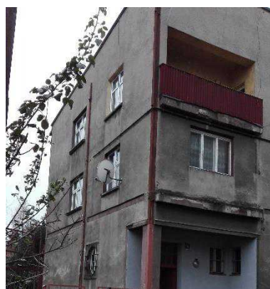
Zarębskiego 7a – przed modernizacją
